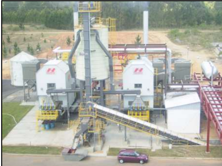
Figura 10: Modulo Gerador de Energia Eletrica
